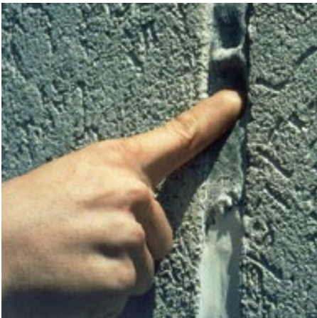
Rissbildung und Adhäsionsverlust bei Polyurethandichtstoffen
